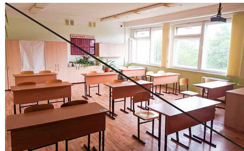
Плохо Линолеум под дерево
